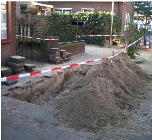
Onderhoud kabels en leidingen
